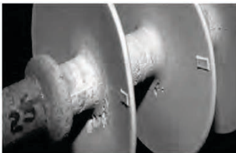
รูปที่ 2 การเสื่อมสภาพของอุปกรณ์บนระบบสายส่งไฟฟ้าในสภาวะกำลังไฟสูง (High voltage) จากการทดสอบโดยการเร่งอายุหลัง 5 ปี [22]
