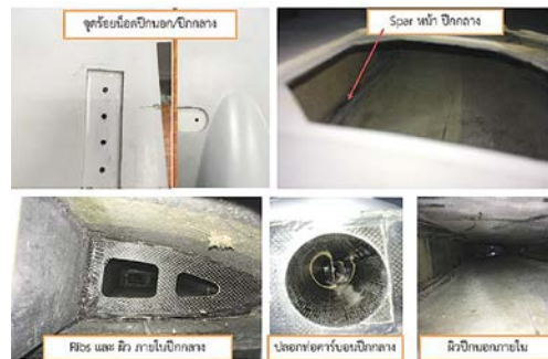
รูปที่ 23 การสำรวจความเสียหายของโครงสร้างปีก (แผนแบบเดิม) หลังการทดสอบ
